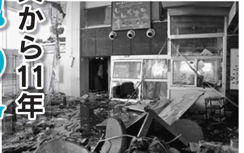
津波により破壊された宮古市役所1階ロビー (宮古市ホームページより)
